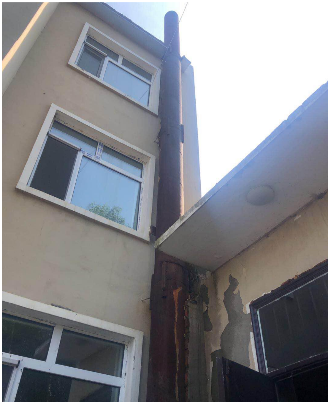
附图：锅炉烟尘高空排气筒
